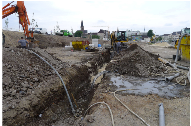
Foto: Das Sondenfeld (ERDWÄRME21 GmbH)
