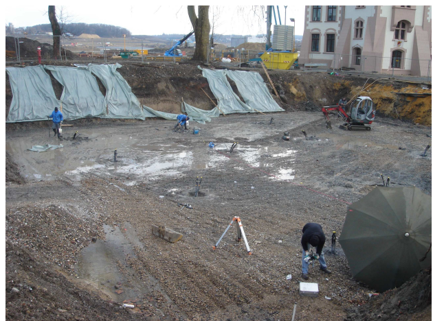
Foto: Das Sondenfeld (ERDWÄRME21 GmbH)
